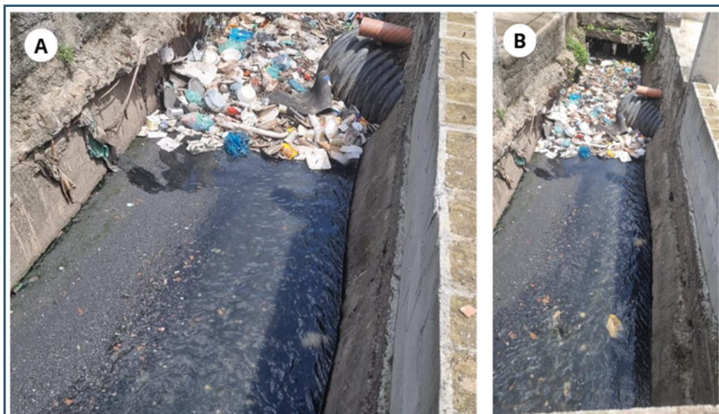
Figura 4 – Ponto degradado do curso principal do Rio Neves (Coordenada UTM: 695477.39, 7471727.92)
