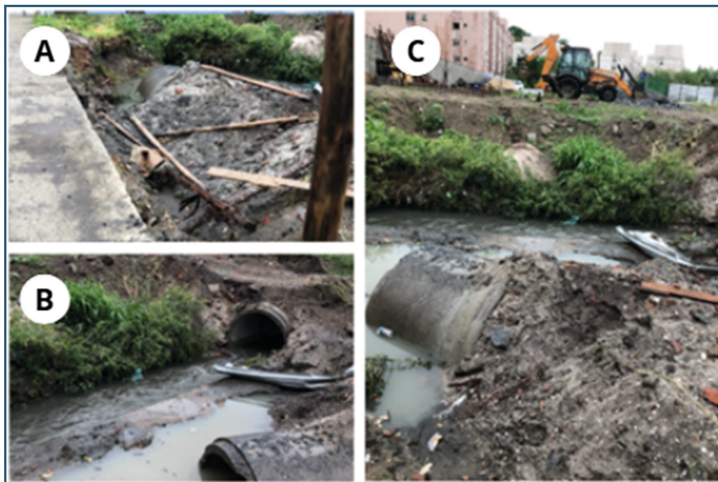
Figura 7 – Canalização inadequada de um dos cursos de água do Rio Neves (Coordenada UTM: 695363.107, 7471798.643)
