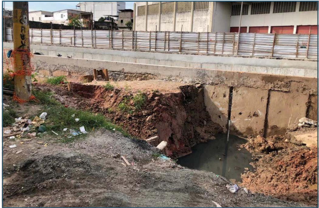
Figura 2 – Favela da Vila Ideal, Duque de Caxias, Rio de Janeiro, com esgoto à céu aberto, registro feito em frente de algumas casas de moradores da região
