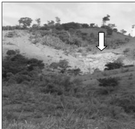
Foto 5: Processo erosivo em morro desmatado e com pastagem.
