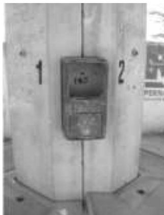
Figura 7: Detalhe do medidor pré-pago
