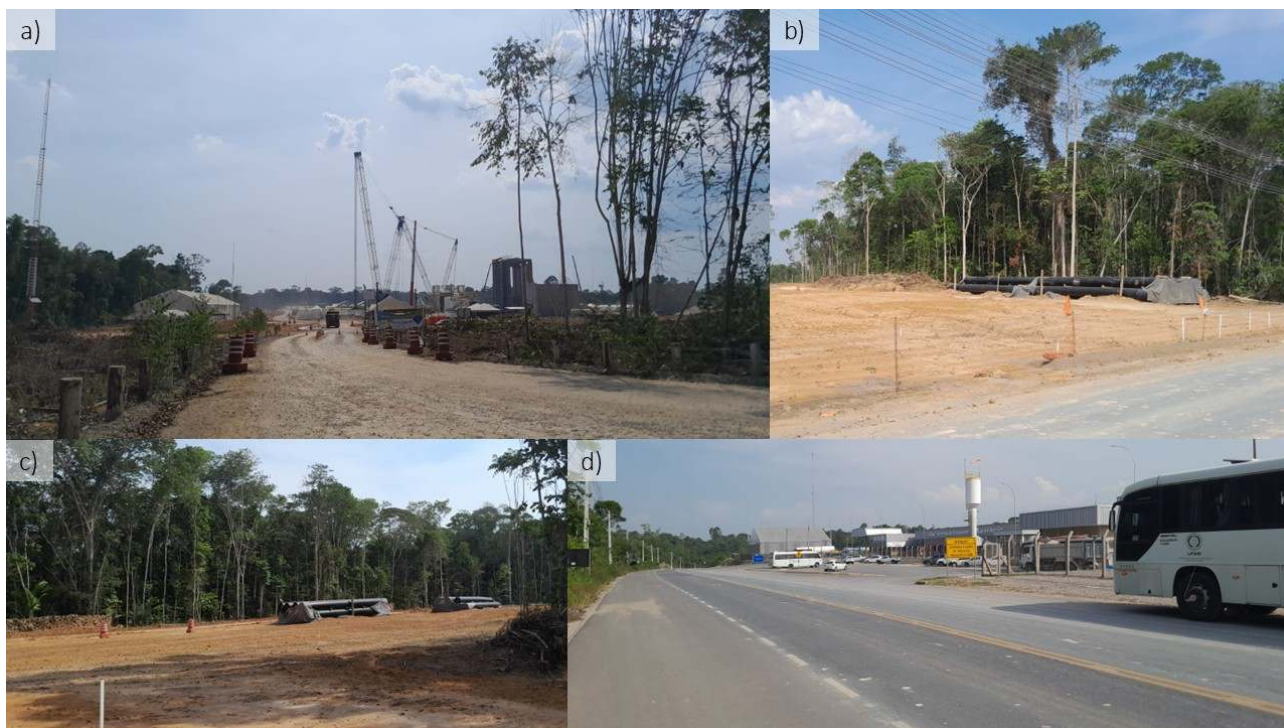
Figura 08: Complexo Azulão: a) canteiro de obras do complexo Azulão 950; b) e c) área desmatada para construção de adutora; d) complexo industrial que opera desde 2021.
