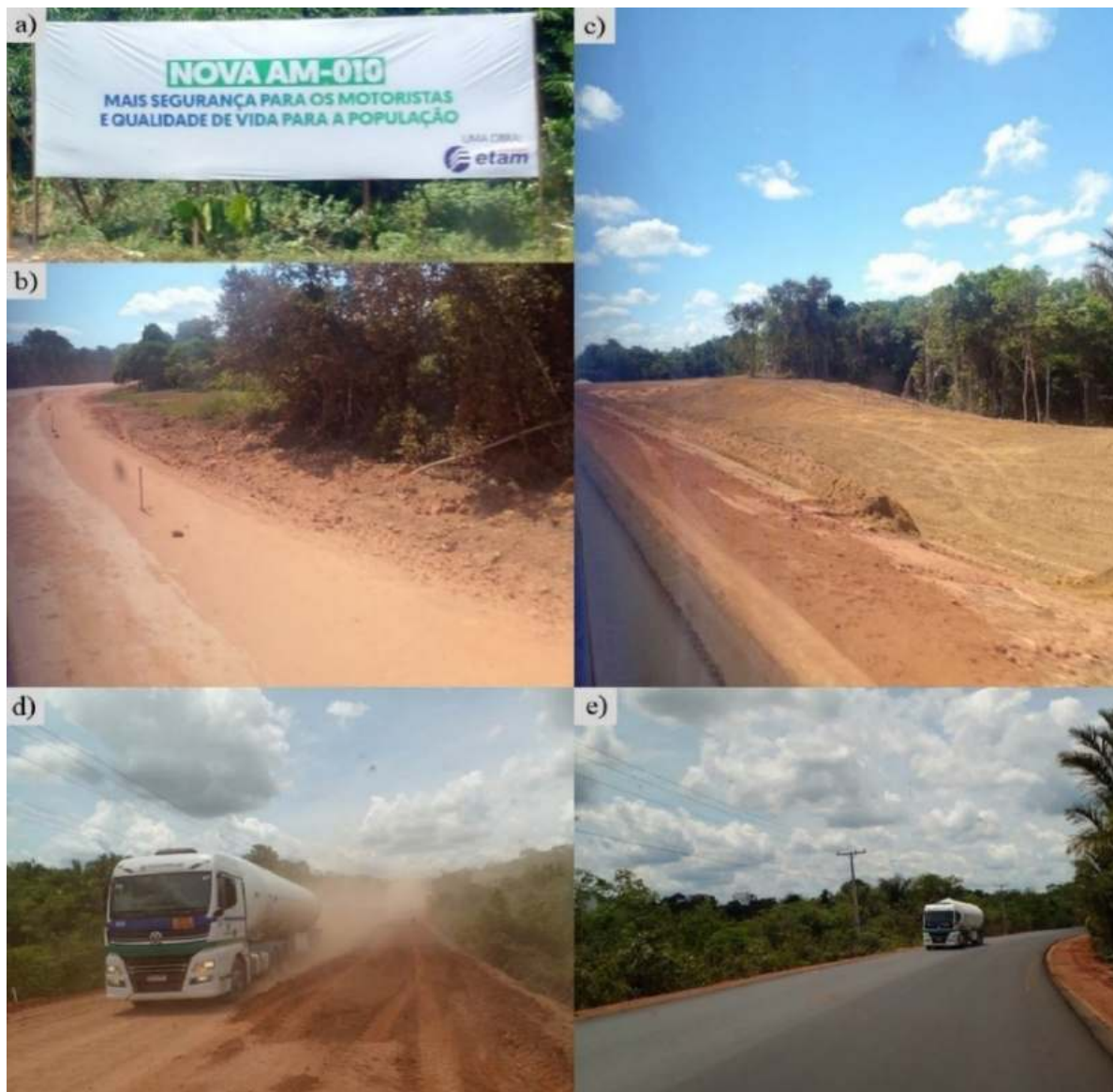
Figura 09: Modernização da rodovia estadual Manaus-Itacoatiara AM-010: a) placa indicando que a rodovia está passando por obras de modernização; b) trecho alargado da rodovia; c) trecho reconstruído e preparado para o recebimento da pavimentação asfáltica; d) trecho em obras e caminhão transportando GNL; e) trecho recém pavimentado e carreta de transporte de GNL.
