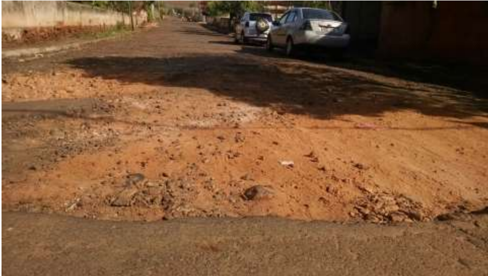
Figura 11. Santa Mariana (PR). Pavimentação deteriorada Fonte: Trabalho empírico – 2016
