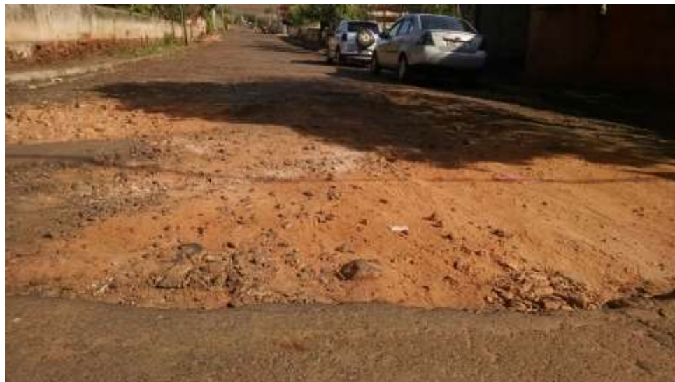
Figura 11. Santa Mariana (PR). Pavimentação deteriorada
