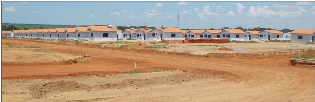
Figura 2: Residencial Guterres, no bairro Tuiuiu, Primavera do Leste – MT. Casas em fase de acabamento no Residencial Guterres, financiado pelo Programa Habitacional Minha Casa Minha Vida. Foto do autor. 27 nov. 2015.
