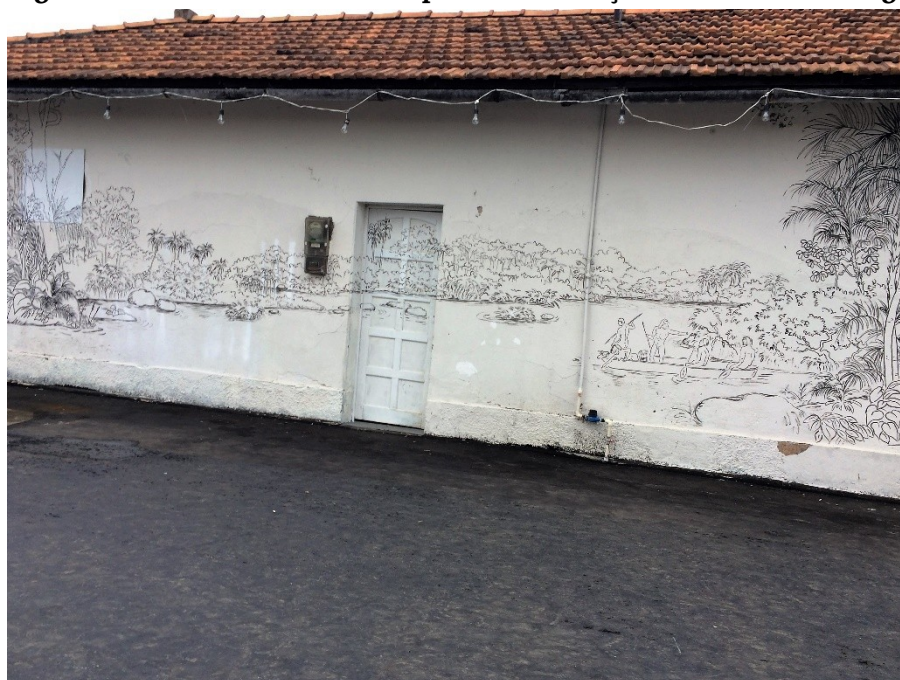
Figura 6. Fachada alterada em parte do terraço da Fábrica Bhering.
